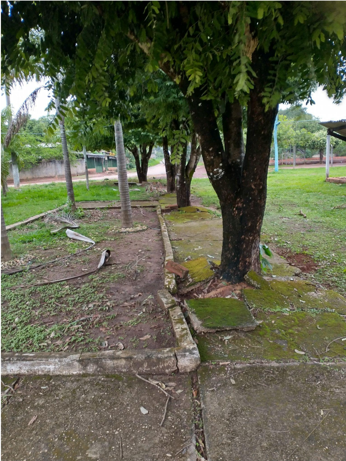
Figura 28: Elementos construtivos danificados por árvores
