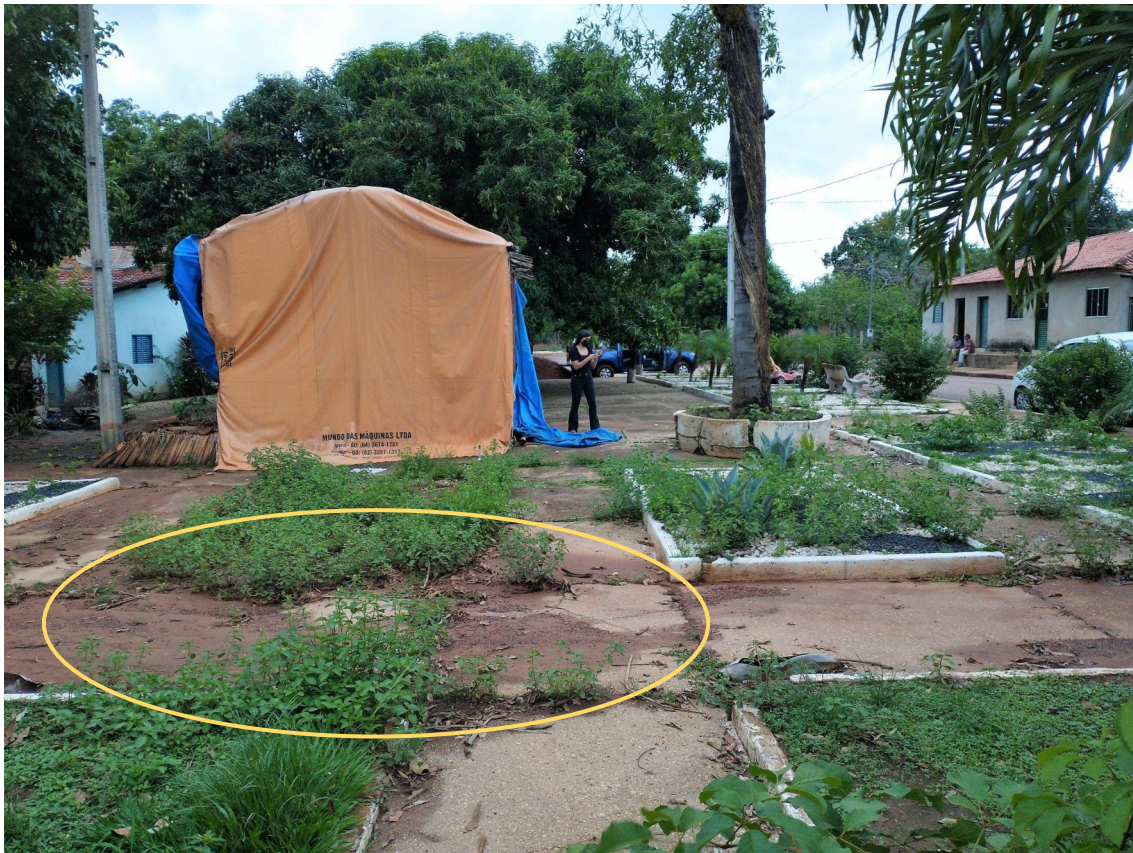
Figura 30: Recalque em placa de concreto
