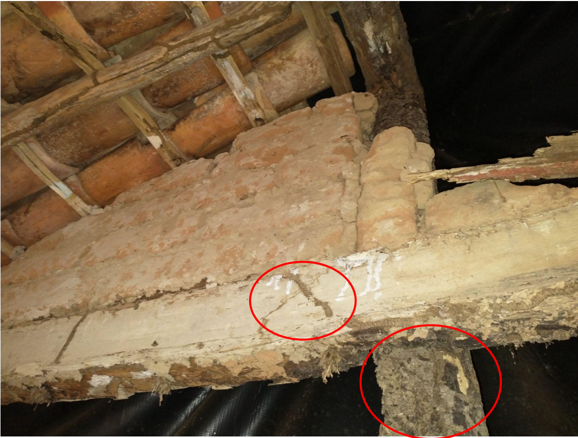
Figura 18: Registro Posto Telegráfico - Deterioração de elementos de madeira
