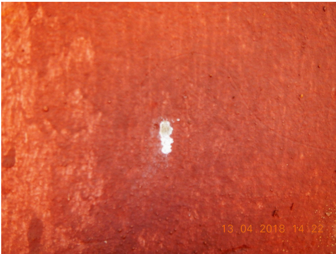
Figura 14: Registro Posto Telegráfico - Raspagem em reboco
