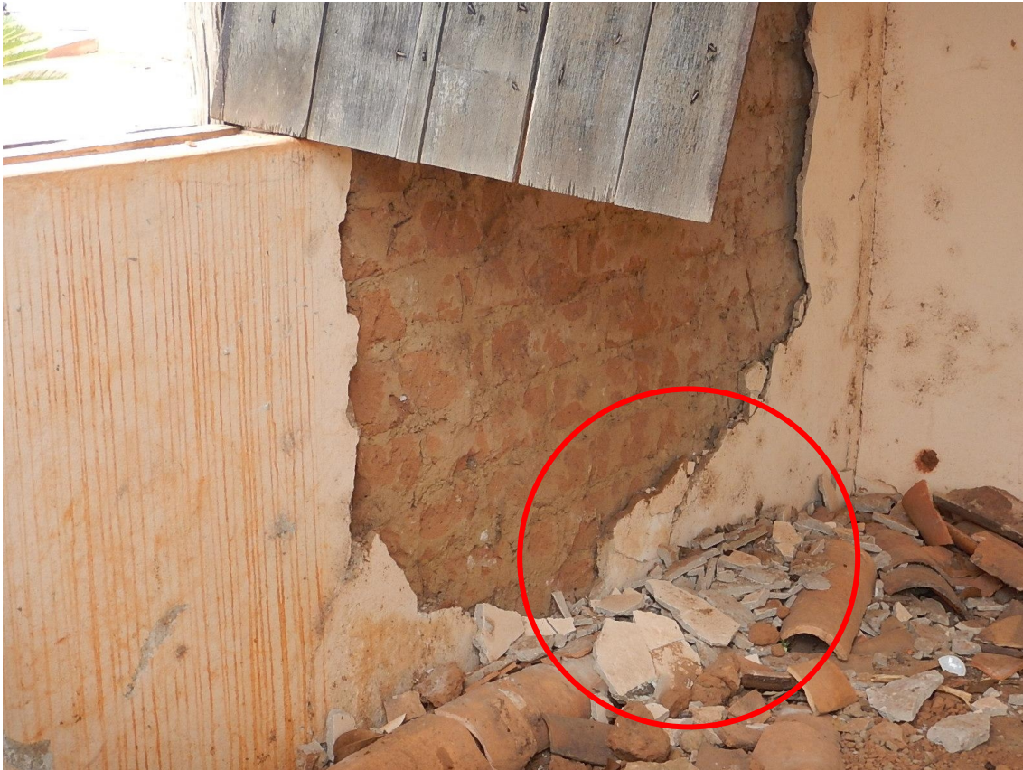
Figura 11: Registro Posto Telegráfico - Detalhe reboco
