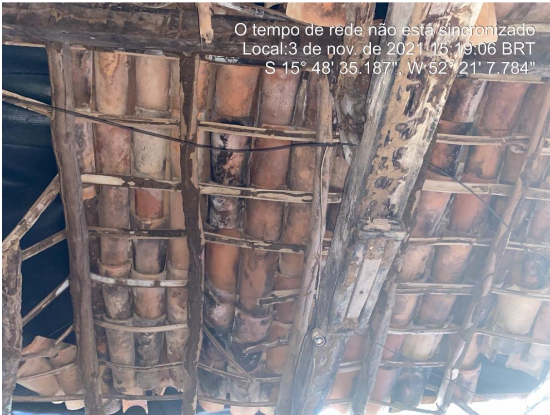
Figura 19: Registro Posto Telegráfico - Presença de inseto xilófago em trama de telhado
