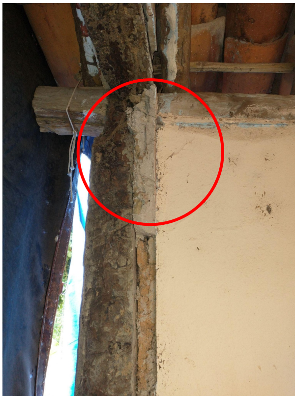
Figura 10: Registro Posto Telegráfico - Detalhe reboco
