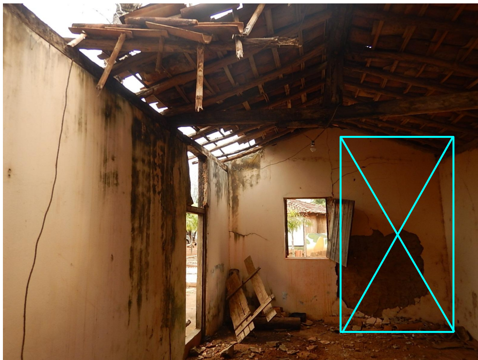
Figura 7: Registro Posto Telegráfico - Parede noroeste antes de sua ruptura e queda
