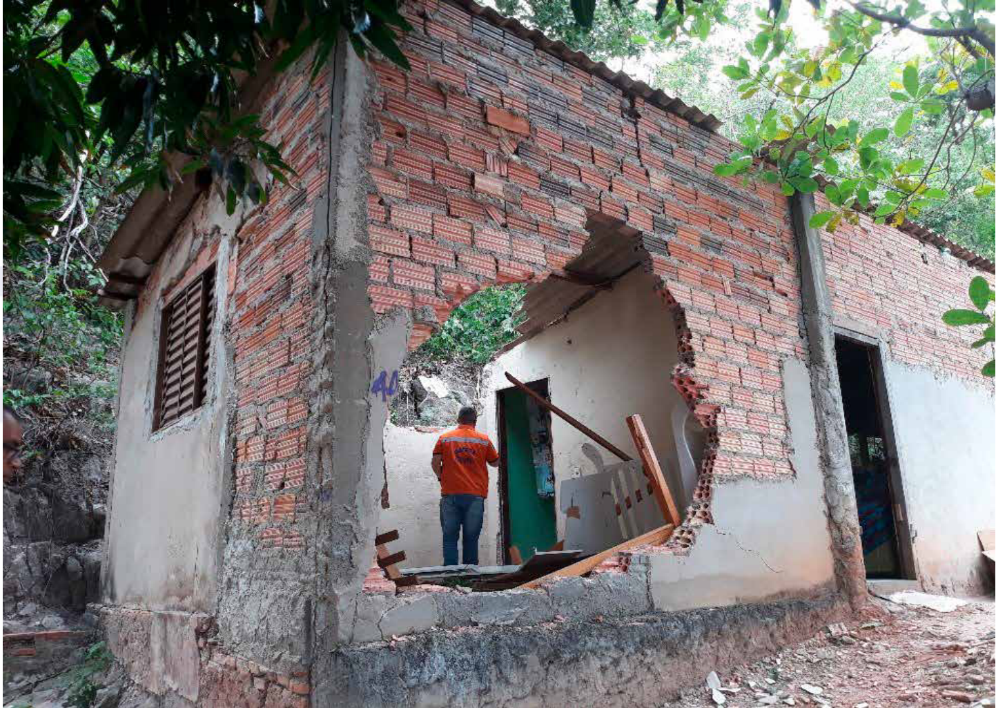
Figura 08 - Caso de rolamento de Bloco bairro Vila Santo Antônio Fonte: Borges, (2020).
