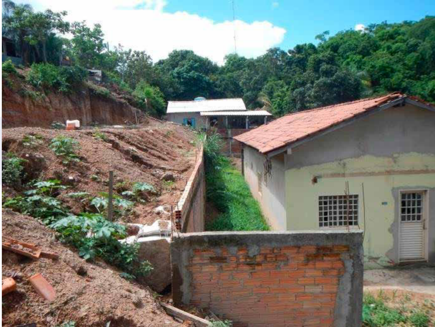
Figura 13 - Corte de talude e aterro lançado elevado embarrigando muro mal construído Fonte: CPRM, (2018).
